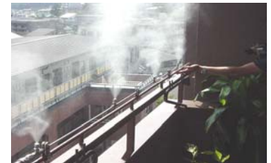
図 1: 家庭用に設置された第一世代ドライミスト装置
